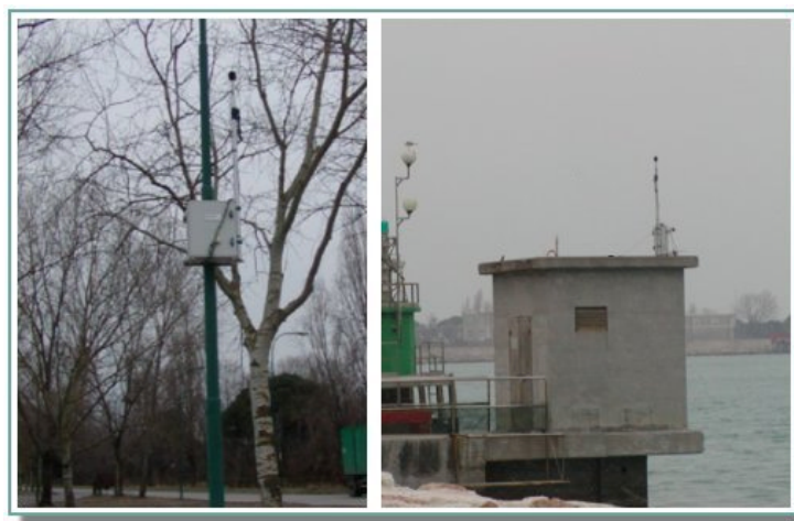
Figura 3 – installazione su palo stradale e su cabina in prossimità di un molo
